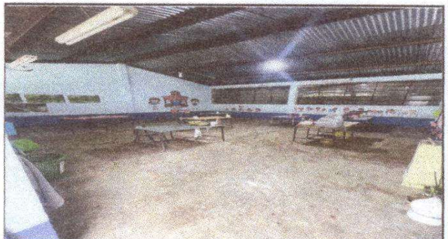
Foto 4 Cambio de lámparas por poca iluminación
