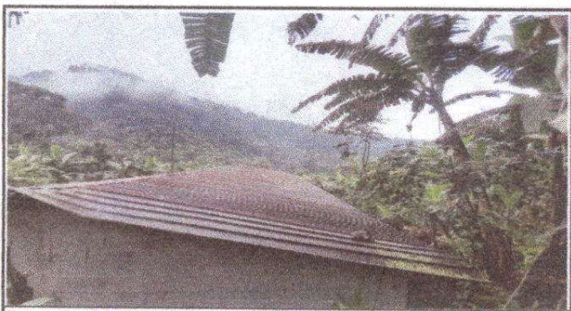
Foto 5 Cambio de lámina por ingreso de agua en época de lluvia
